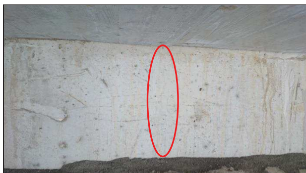
Foto. 1 Zvislé zmrašťovacie trhliny v úložnom prahu
