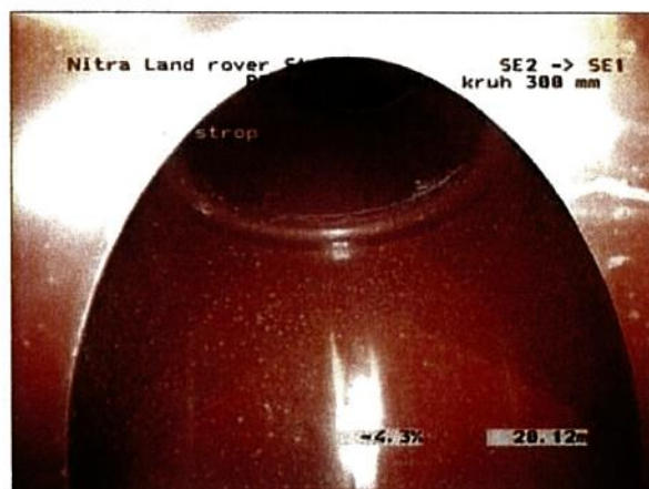
Foto: 46_2a 20,12m, Pripojka, strop
