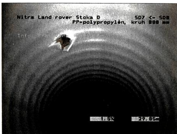
Foto: 3_3a 29,85m, Info: Prasklina vypadnute podložie
