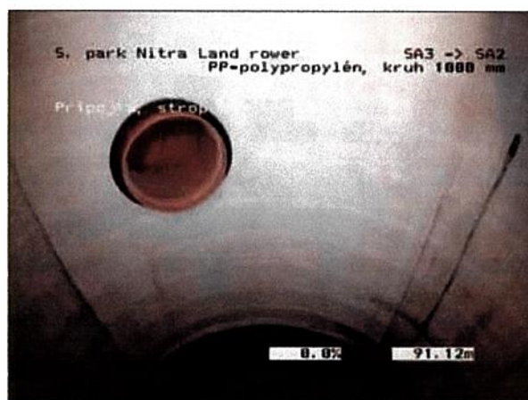
Foto: 5_5a 91,12m, Pripojka, strop
